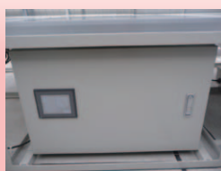
直流電源装置
