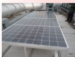
約1 kWの太陽光パネル
