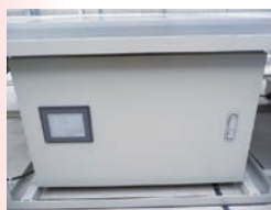
直流電源装置
