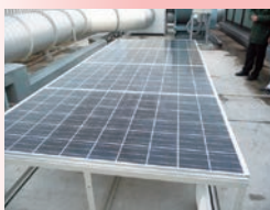
約1kWの太陽光パネル
