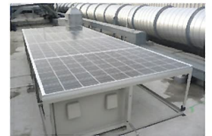
約1kWの太陽光パネル
