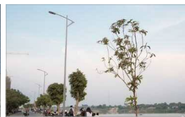
高効率LED街路灯の無線 制御（三菱電機）
